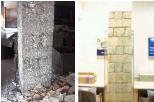
Fig. 11 y 12. Limpieza de revoque en columnas principales del salón principal, realizadas en piedra en la planta baja. Vista actual de la columna en la actualidad institución financiera FASSIL S.A.
